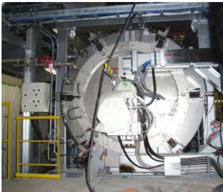
真空加熱分離装置
