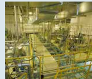
●PCB受入調整設備 PCBを含んだ油を種類毎に受け入れ、PCB濃度を調整した後、PCB脱塩素化分解設備へ送ります。
