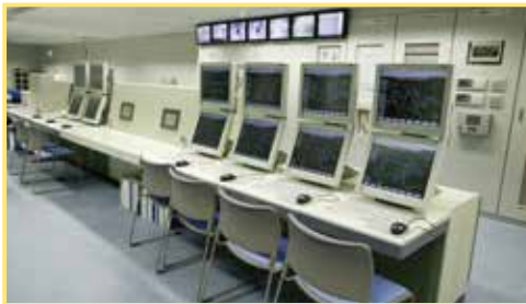
●中央制御室 本施設の頭脳ともいべき場所で各設備をコンピュータにて24時間監視・制御しています。
