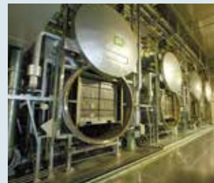
●含浸物洗浄設備(真空加熱分離) 窒素雰囲気下で加熱した含浸性部材を真空引きして残ったPCBを蒸発させ、取り除きます。
