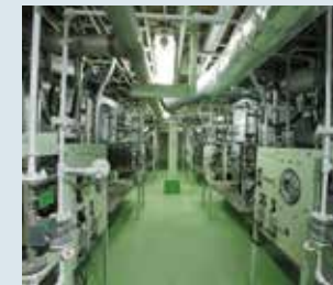
●PCB脱塩素化分解設備 PCB廃棄物から分離したすべてのPCBを、脱塩素化剤と反応させ、分解し、無害な物質に変えます。
