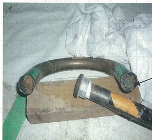
写真2 冷却配管の閉塞状況
