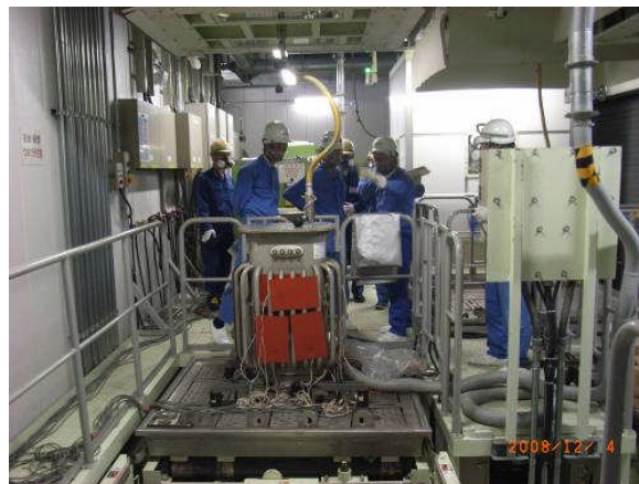
写真11 トランス予備洗浄室の視察
