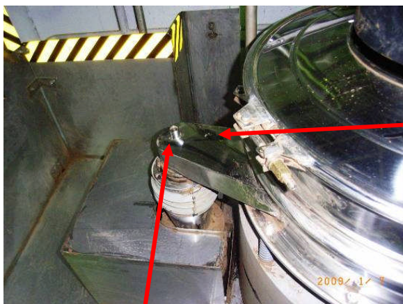
写真8 スラリー出口：空気穴から漏洩
