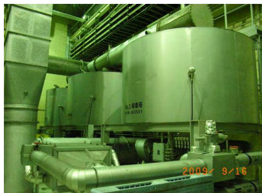
写真1 有機溶剤処理装置
