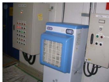
気化式冷風機(洗浄室他3箇所)
