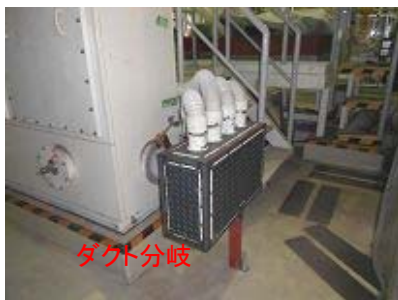
局所排気の場所が限定され分岐した移動式ダクトにより、カバーできる作業範囲を広げた
