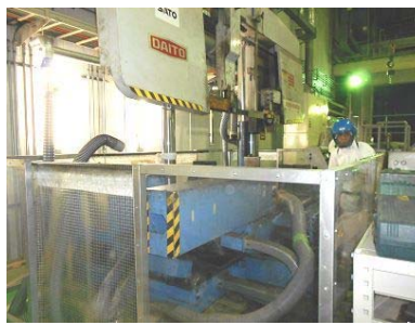
大型バンドソの囲い及び局所排気ダクト
