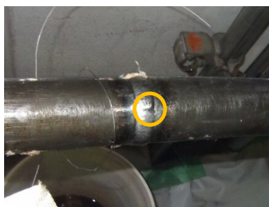
図8 漏れ箇所(ビード上)
