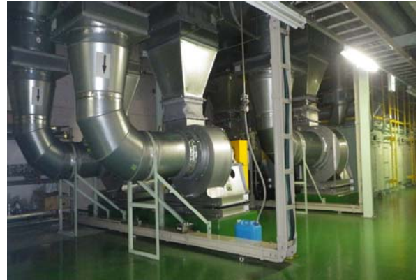
排気処理装置(送風機)
