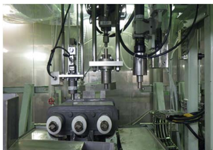
コンデンサ油抜き取り 本体に穴を開けて抜油管を挿入し、コンデンサ油を抜き取る。
