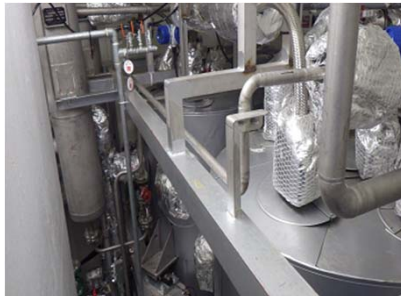
抜油受槽 抜き取った油を受け入れる。
