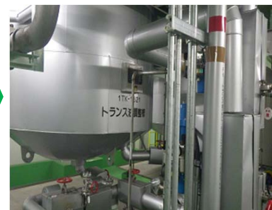
塩素濃度調整槽 鉍物油を加え、塩素の濃度を21.5%に調整する。
