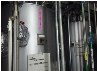
抜油受槽 抜き取ったトランス油をPCBとトリクロロベンゼンに分離し、PCBを受け入れる。
