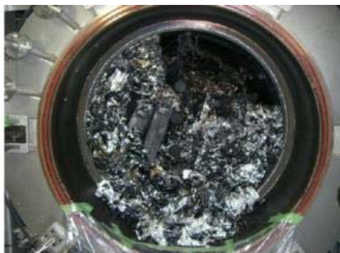
(ポリプロピレンを使用したコンデンサの炉内破裂した際の状況)
