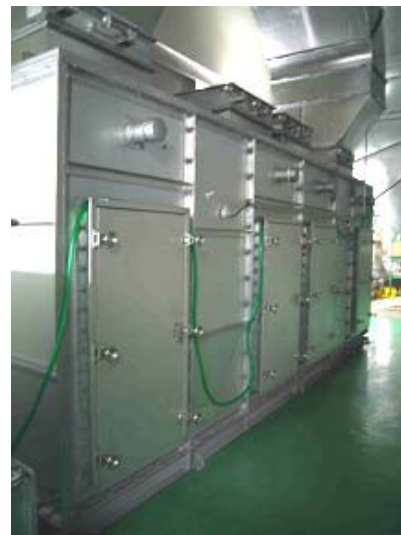
活性炭吸着槽
