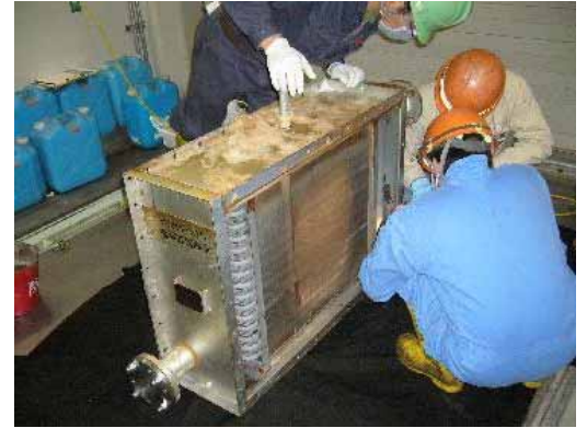
破損した冷却用熱交換器の調査
