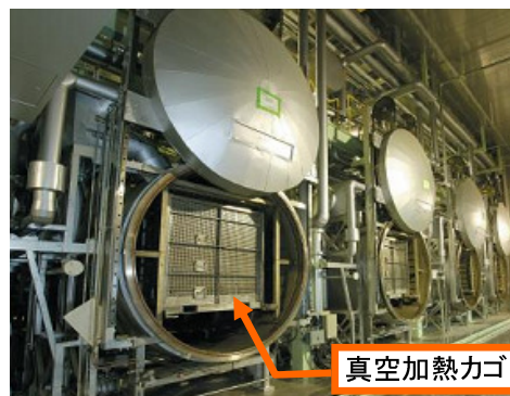
真空加熱分離装置
