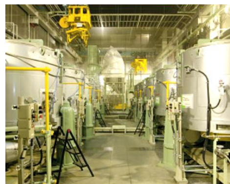
攪拌洗浄装置
