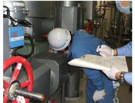
熱交換器の点検(ボイラー室内)
