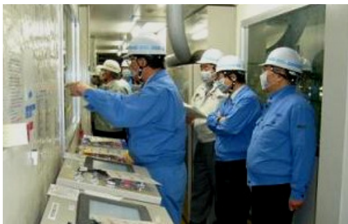
不具合が発生した設備の現地確認
