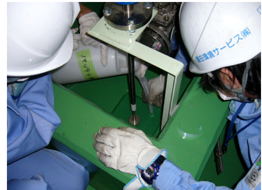
漏洩検知器の検査
