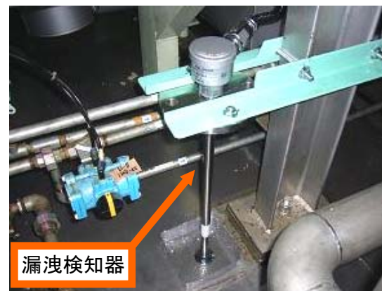
追加設置した漏洩検知器
