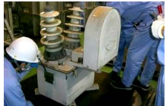
小型トランスの受入検査 (PCB油が漏れていないか確認)
