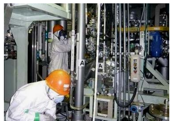
洗浄設備(真空加熱エリア)の定期点検
