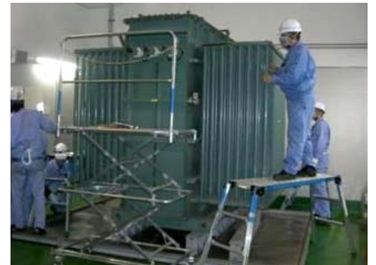
大型トランスの受入確認 (PCB油の漏れの有無の確認)
