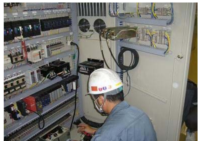
真空加熱装置の制御盤に対する定期点検
