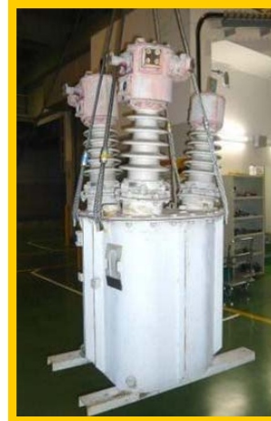
受入室に搬入された計器用変圧変流器
