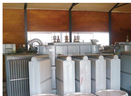
この大型トランスは、総重量5.4t、油量1,300L、高さ2.1m×幅2.45m×奥行2.3mのもの
