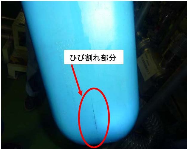
1階蒸留エリア内のひび割れしたポリタンク
