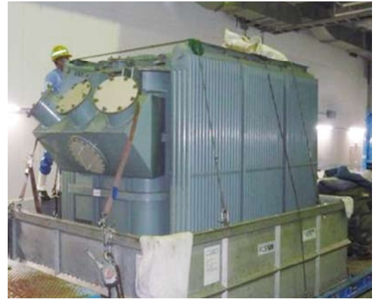
漏れ防止型金属トレイにて搬入された超大型トランス
