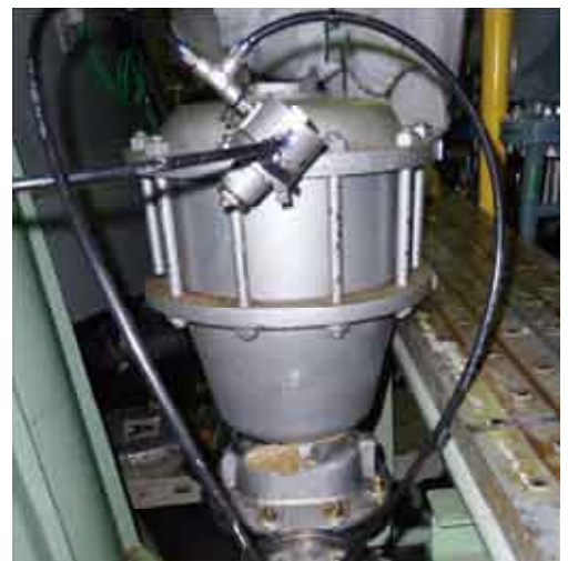
漏洩箇所の排水弁
