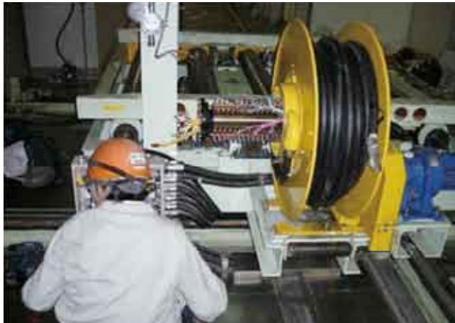
搬送トラバーサ点検
