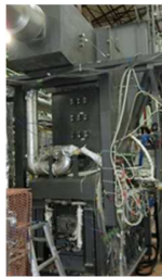
図3 焼却試験装置外観
