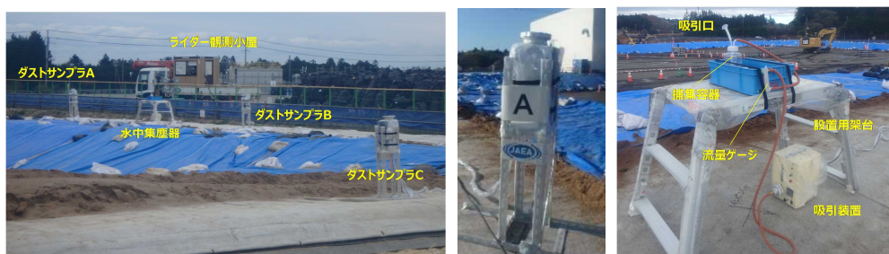
図 3-3 現場における試験機器の設置状況 （左：全体の状況、中：ダストサンプラの設置状況、右：水中集塵器の設置状況）
