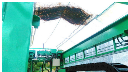
図 2-8 ろ布破損時の噴出状況
